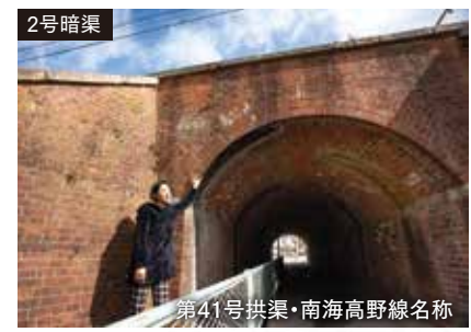
2号暗渠 第41号拱渠・南海高野線名称 断面は欠円アーチで設計されているのが特徴。スプリングラインに迫受石を設けている。欠円アーチはある程度の径間を維持し空頭を確保する設計。
