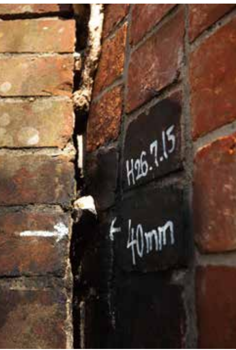
【ひずみについて】 上図は暗渠の安全を保つ為に毎年計測されるレンガ積みのひずみ幅の数値を記したものです。
