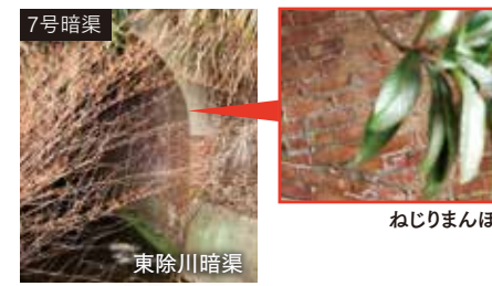
7号暗渠 東除川暗渠 ねじりまんぼ 線路方向に対して斜めにアーチを架けるためにアーチ部分のレンガをねじって積んだ「ねじりまんぼ」の構造。線路の下を左60度の交差角で横断。断面は正径間3.6m(12フィート)の単心円。側壁とアーチの部分接続工事難。
